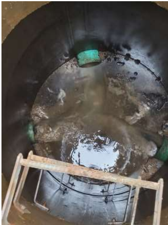
Accumulation de débris dans un regard dans un regard (STEP 2021-04-15)
