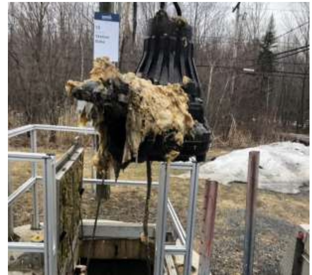
Accumulation de débris sur une pompe (source : www.journalexpress.ca )
