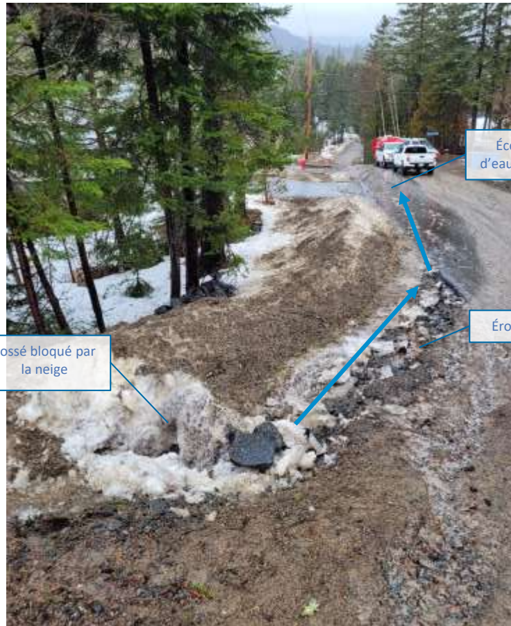
Débordement du fossé - Rue du Domaine (2021-03-26)
