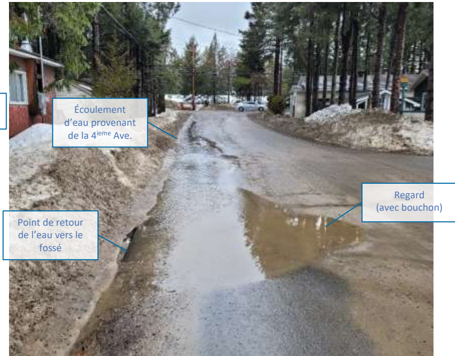
Débordement du fossé - Rue du Domaine (2021-03-26)
