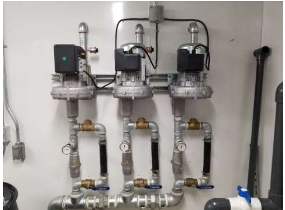
Soufflantes – Vue d'ensemble (2020-12-08)
